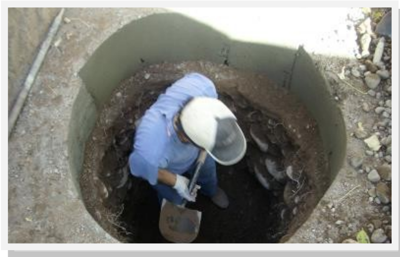
Foto 1: Trabajos en espacios confinados: Sin EPP c/peligro de desmoronamiento!!!
